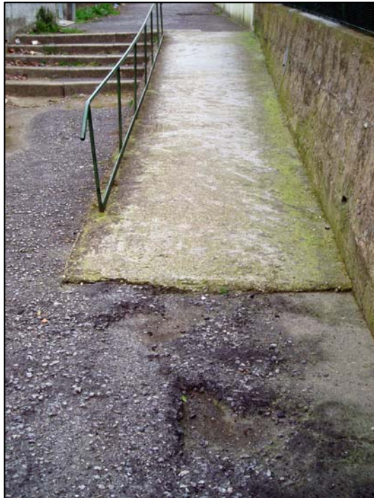
foto 9: particolare del percorso pedonale del Rio, nel Capoluogo. La superficie di calpestio si presenta, in molti tratti, in cattive condizioni di manutenzione, tali da costituire ostacolo alla mobilità.
