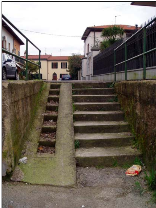
foto 10: rampa laterale al percorso pedonale del Rio, nel Capoluogo. Esempio di accessibilità non a norma
